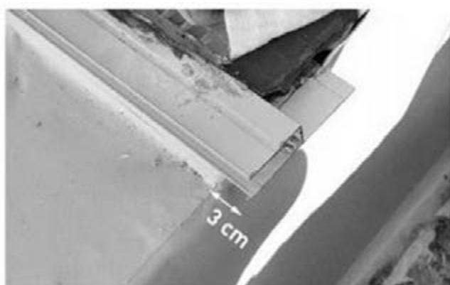
Esuberato della guida di 3 cm nel vano della copertura
